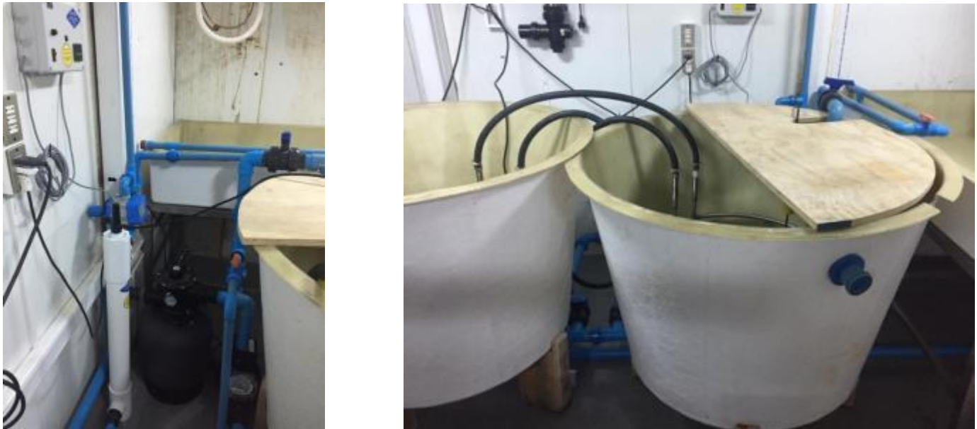
Figura 2. Sistema de filtración y enfriamiento del sistema de acuarios.
